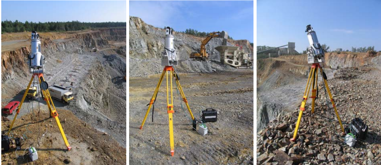
Abbildung 4: Wahl der drei Aufnahmepositionen für den Scanner vor der Sprengung (Abbausituation A)
