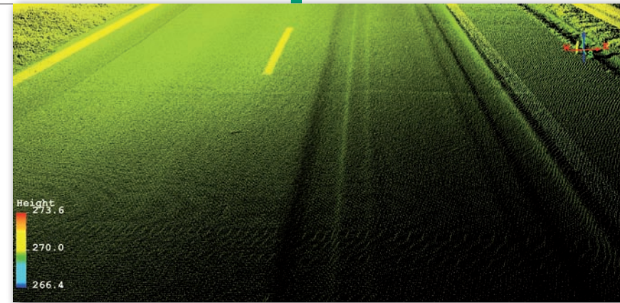
Rys. 5. Widok chmury punktów autostrady A1 i widoczne koleiny
